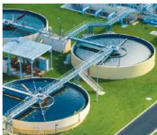
Figura 2. Stație de epurare a apei
