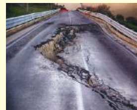
Figura 5. Drum afectat de alunecare de teren
